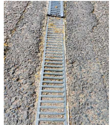
Kuva 9 Tukkeutunut ohjausura. Kuva: Liina Kuittinen 2025
